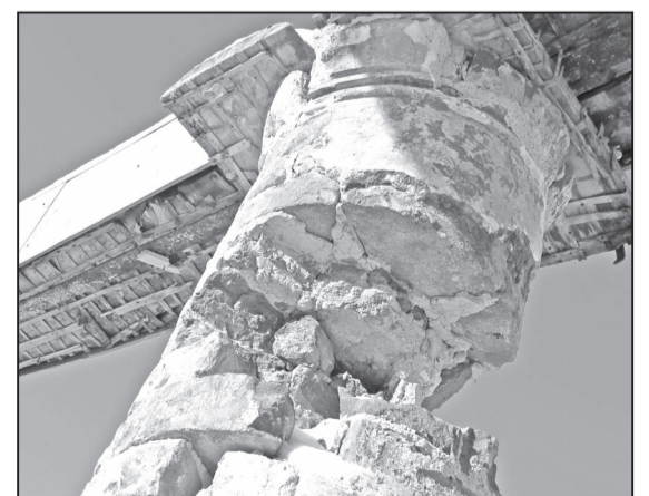
Одна из тех самых исторических колонн, которая пережила «советское вмешательство» и уцелела под ковшом экскаватора минувшим летом, когда начали работы по переоборудованию
