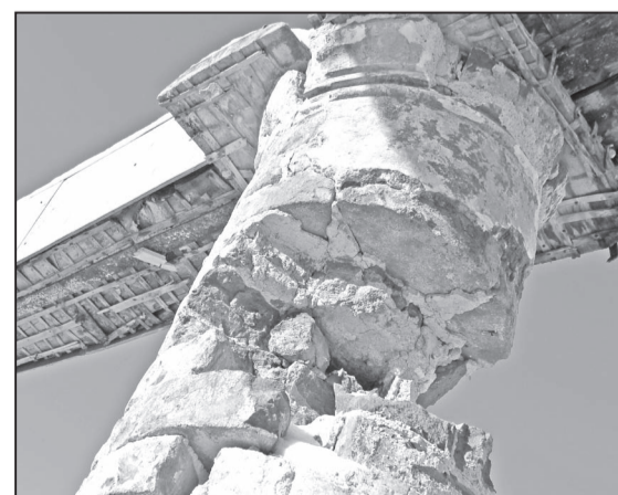
Одна из тех самых исторических колонн, которая пережила «советское вмешательство» и уцелела под ковшом экскаватора минувшим летом, когда начали работы по переоборудованию
