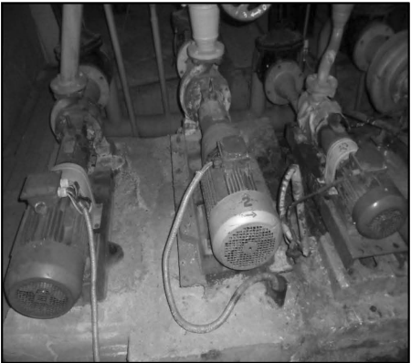
Фото 8. Кот №1. Насосы циркуляционные ГВС №№1,2,3
