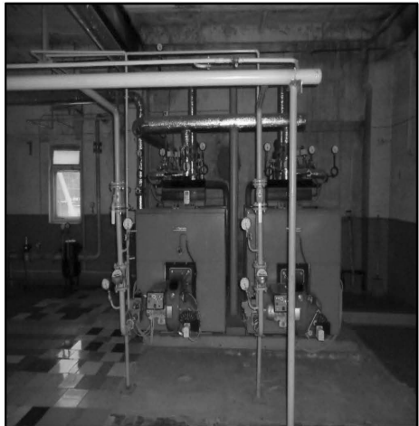
Фото 6.Кот №1. Водогрейные котлы Buderus №№9,10
