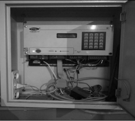
Фото №14. Кот №1. Корректор ТЭКОН 17
