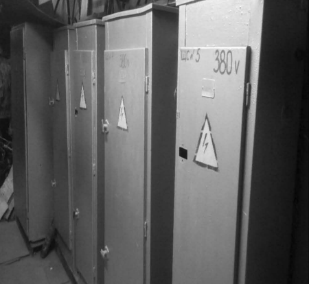
Фото 18. Кот №1. Силовые щиты380 В
