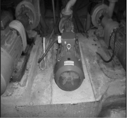
Фото 9.Кот №1. Насосы сетевые №№4,5,6
