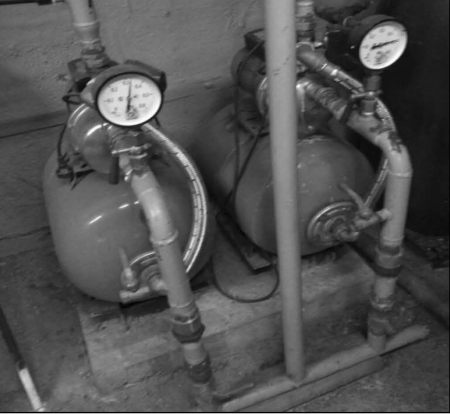
Фото 10.Кот №1. Насосная станцияWilowj-203-em-mod
