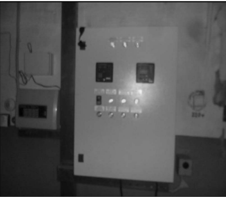
Фото 16. Кот №1. Щит аварийной сигнализации
