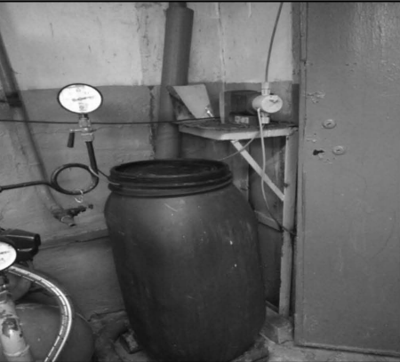
Фото №12.Кот №1. Установка дозирования ИОМС-1
