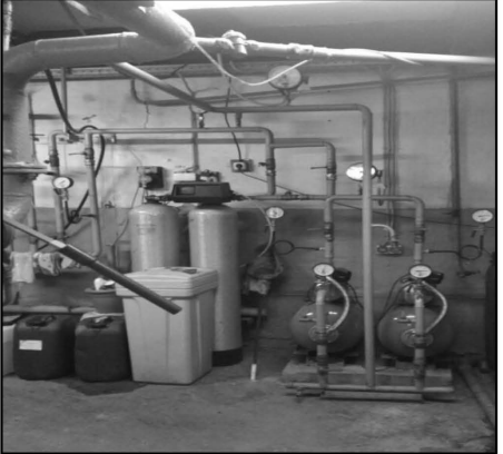
Фото №11.Кот №1. Водоподготовка
