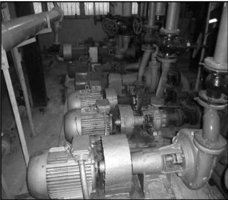
Фото 7. Кот №1. Насосы котельной
