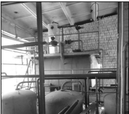
Фото 41.Кот. №5. Деаэратор подпиточный
