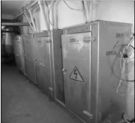
Фото 32. Кот. №2. Силловые щиты 380 В
