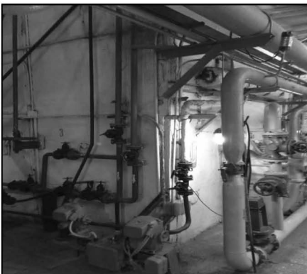
Фото 38.Кот. №5. Котлы ДКВР 10-13. Газовая обвязка
