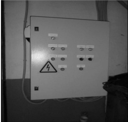
Фото 34. Кот. №2.Щит аварийной сигнализации КСУМ 1 котлов №№1-4
