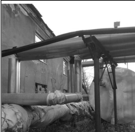
Фото 58.Кот. №6 Бак аккумулятор ГВС направления
