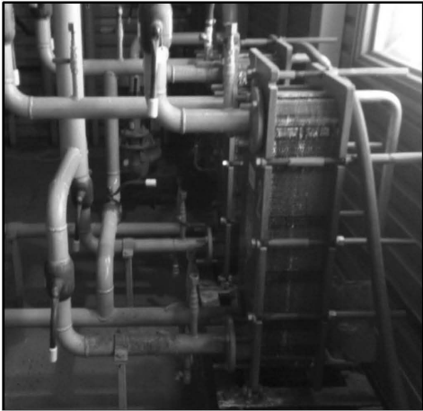
Фото 55.Кот. №6.Теплообменники ГВС
