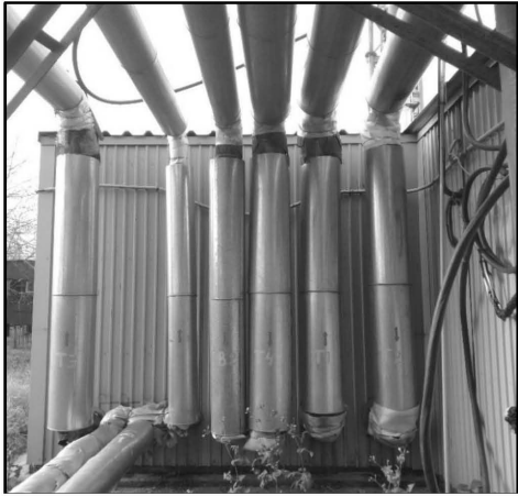
Фото 59. Кот №6. Выход из котельных по
