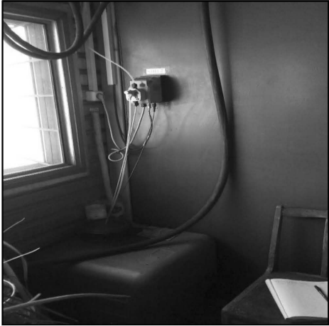
Фото 56. Кот. №6.Установка дозирования
