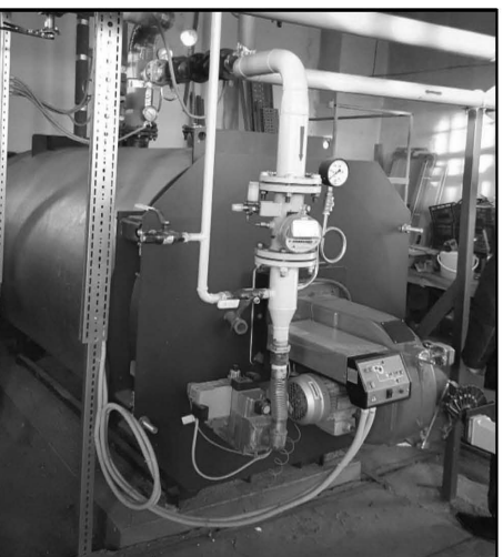
Фото 65. Кот. №7. Котел Термотехник ТТ-100
