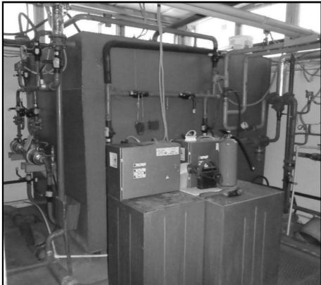
Фото 80.Кот. №8. Установка дозирования и подпиточный бак
