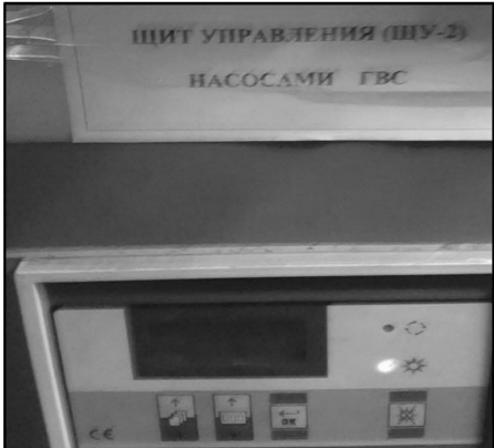
Фото 81.Кот. №8. Щит управления насосами
