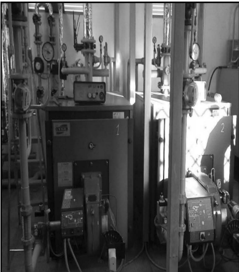
Фото 86.Кот. №11. Котлы водогрейные
