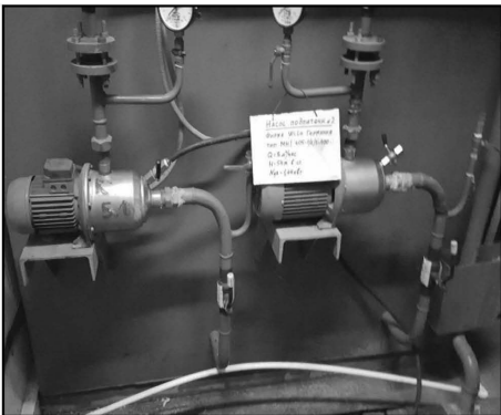
Фото 77. Кот.№8. Насосы подпиточные
