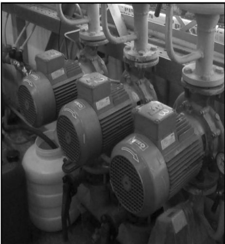
Фото 89. Кот. №11. Насосы сетевые
