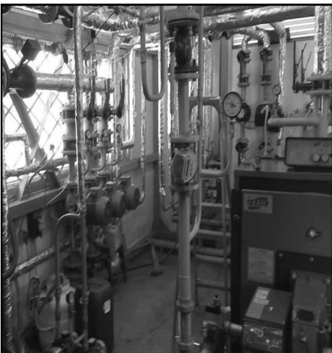
Фото 88. Кот. №11. Общий вид внутри котельной
