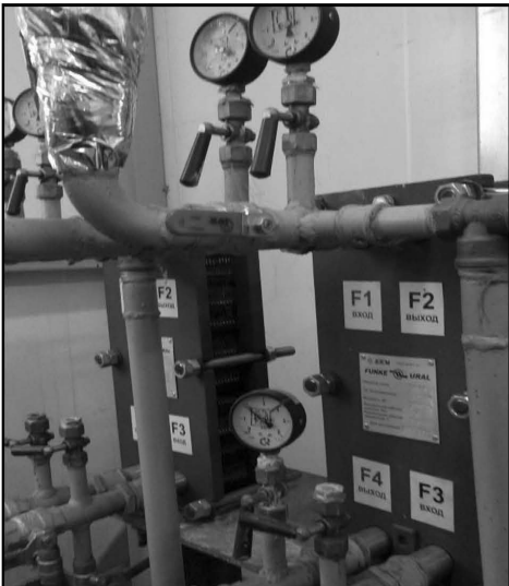
Фото 87.Кот.№11. Теплообменники ГВС
