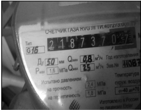
Фото 96. Кот №11.Счетчик газа
