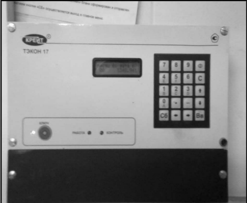
Фото 95. Кот.№11. Корректор ТЭКОН-17
