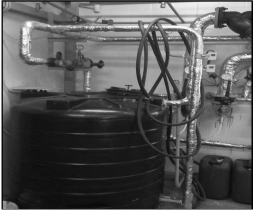
Фото 92. Кот.№11. Бак подпиточный
