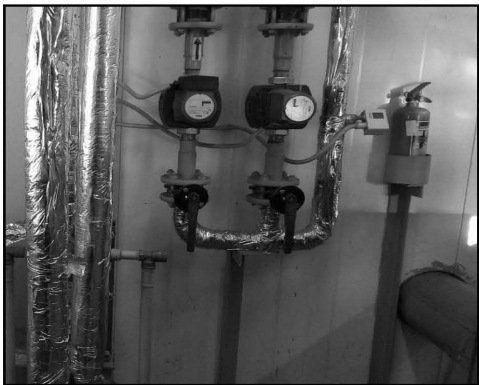
Фото 90. Кот. №11. Насосы ГВС
