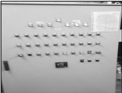
Фото91. Кот. №11.Шкаф автоматики
