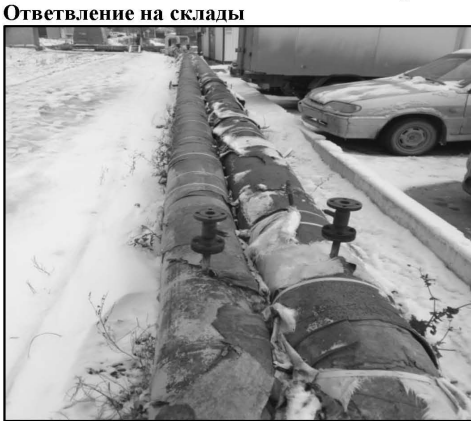
Фото 144-145 Кот. №5 Теплосети в направлении ТП-1 - ТП-2 Сети у д.ул. Красноармейская, 120 к1
