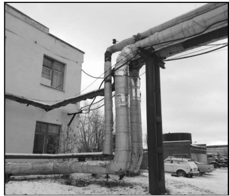
Фото 138-139 Кот. №5. Теплосети на выходе из котельной
