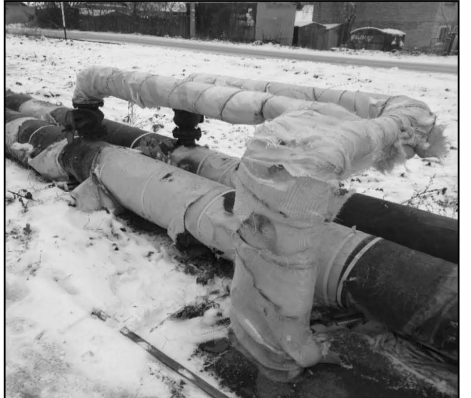
Фото 146-147 Кот. №5 Теплосети в направлении ТП-1 - ТП-2 Ответвления на дома по ул. Декабристов 24-28
