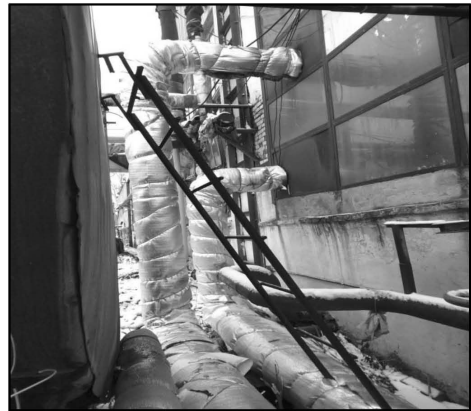
Фото 136-137 Кот. №5. Теплосети на выходе из котельной
