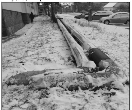
Фото 152-153 Кот. №5 Теплосети в направлении ТП-1 - ТП-2 Сети у д. ул. Красноармейская 118д1
