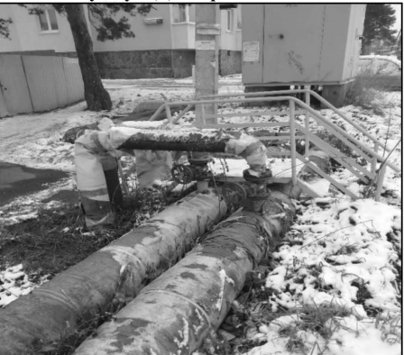
Ответвление на д. ул. Красноармейская 118
