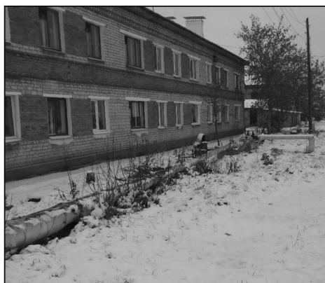
Фото 148-149 Кот. №5 Теплосети в направлении ТП-1 - ТП-2 Сети у д. ул. Декабристов 26
