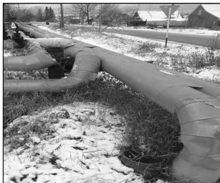
Фото 172-173 Кот. №5. Теплосети в направлении ТП-2 – ТП-3 Сети у ТП-2
