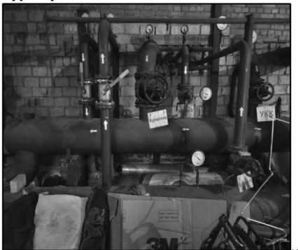
Фото 325-326 Здание ТП г. Арамиль, ул. Курчатова,30-Б (ТП-2 котельной №5) Распределительный коллектор на потребители по направлениям
